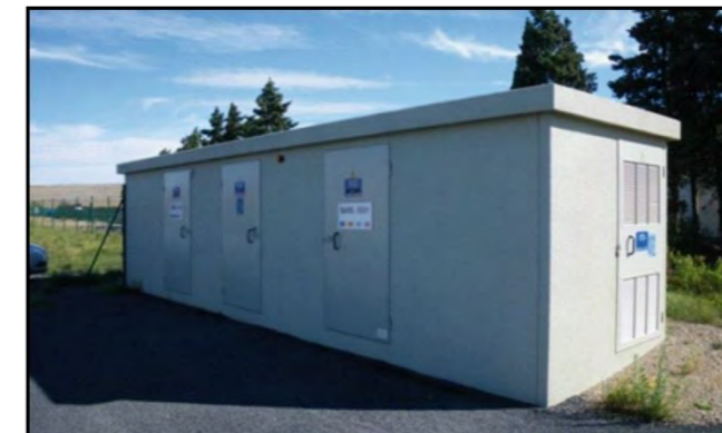
Photographie 78 : Exemple de poste de livraison "brut"
